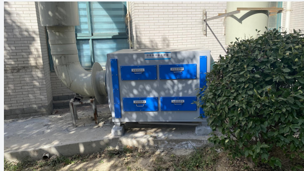
图：公司气体排放末端净化装置
