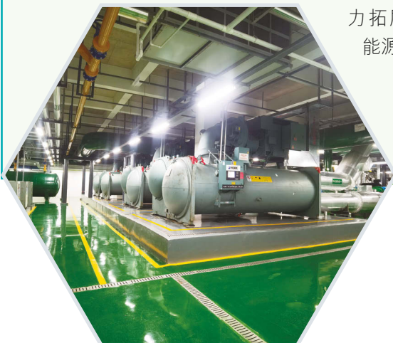
龙旗电子智能硬件制造综合能源站
