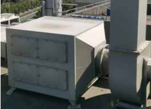
废水、废气治理设施图片
