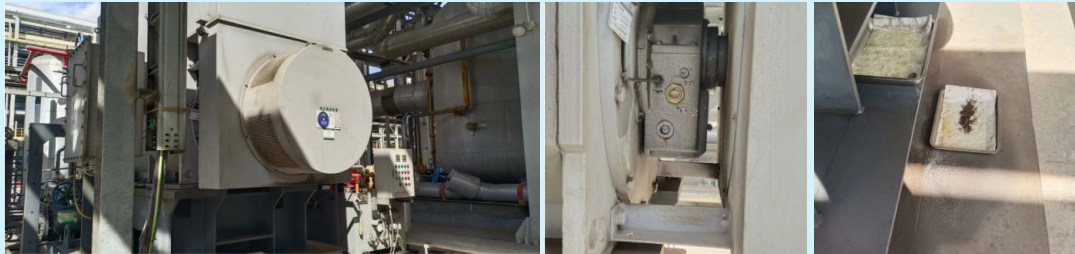
伸尾轴瓦轴贯通处渗油漏油
