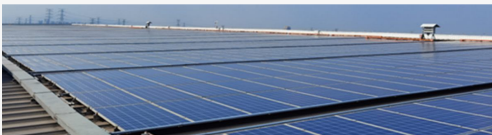
屋顶光伏电站
