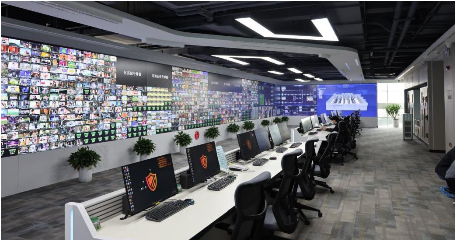
升级后的河北 IPTV 监控大厅
