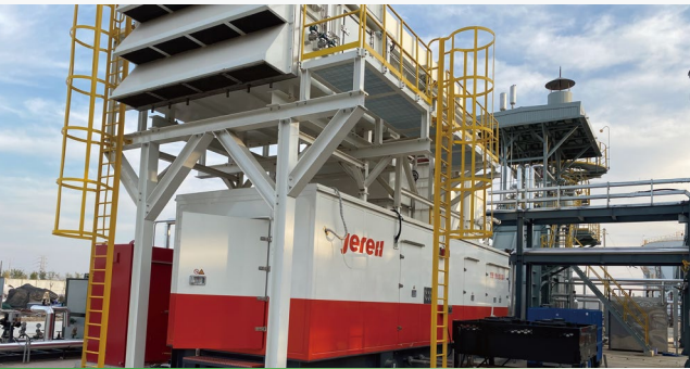
燃气轮机掺氢燃烧发电
