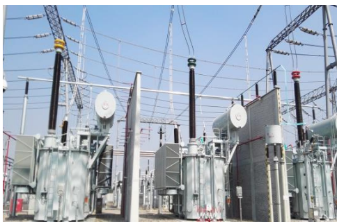
项目名称： 国网镇江上党变 变压器规格： 334MVA/500kV 开关型号： 3xWDLIV
