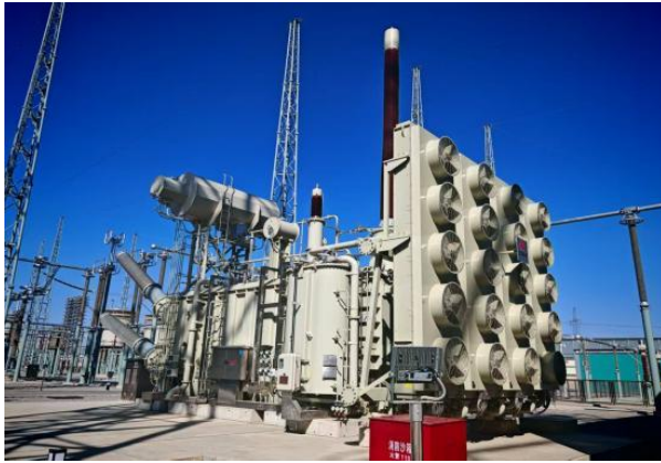
项目名称： 国网陇东换流站 变压器规格： 415MVA/750kV 开关型号： CHVTII
