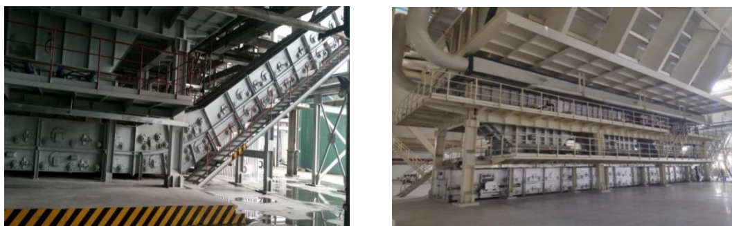
干式炉渣处理系统实景图
