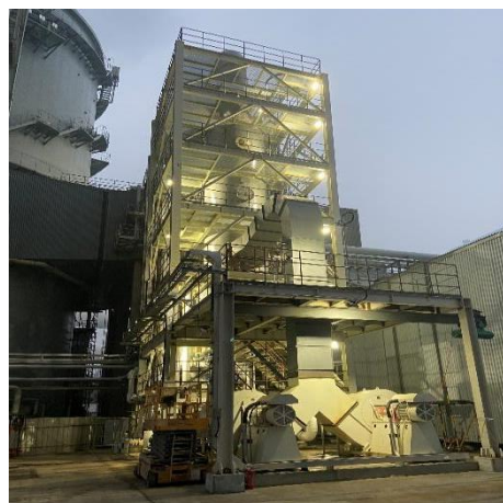
脱硫废水环保处理系统实景图
