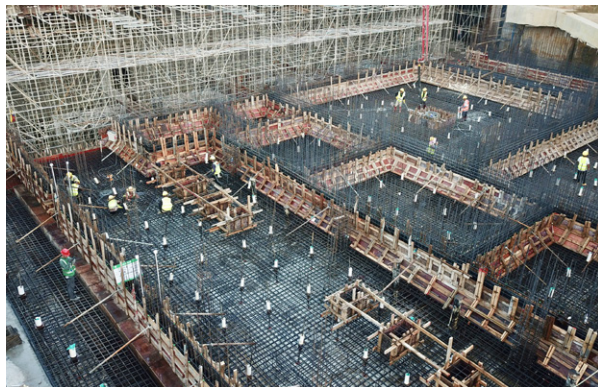
增城开发区下沉式污水处理厂项目
