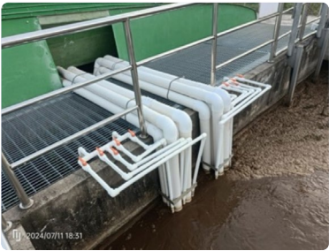
硝化液气提管路现场图
