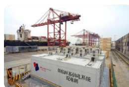
船舶岸电超 100 台套变电设备
