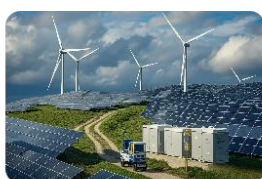
光伏电站及风电场超 17,000 台箱变
