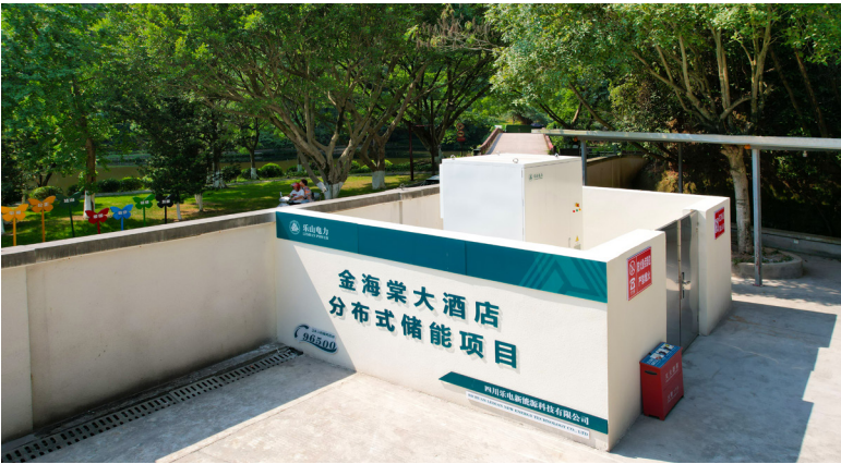
金海棠大酒店用户侧储能示范站
