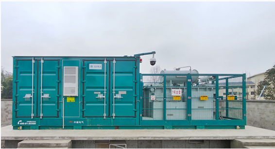
犍为 35 千伏寿保变电站
