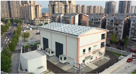
犍为 110 千伏黄旗坝变电站
