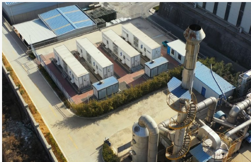
源网荷储项目储能设施
