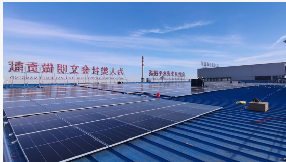
屋顶光伏发电
