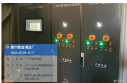
中央空调节能改造
