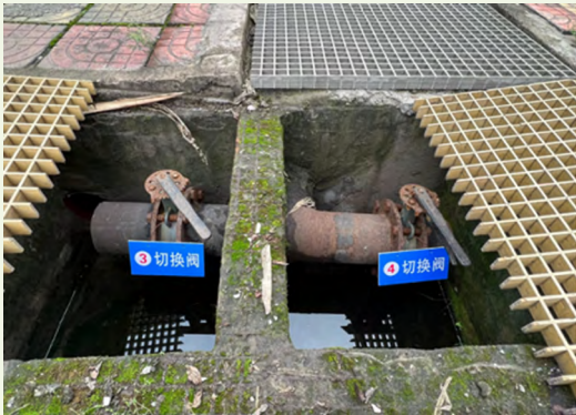
装卸平台雨污切换阀
