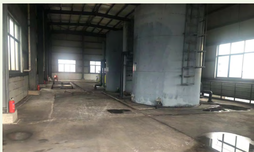
珞璜港污水处理厂及相关设施
