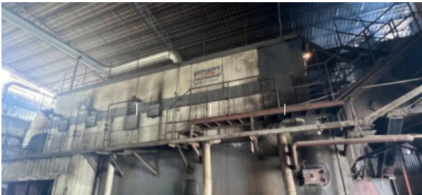
生物质锅炉，推进可再生能源利用
