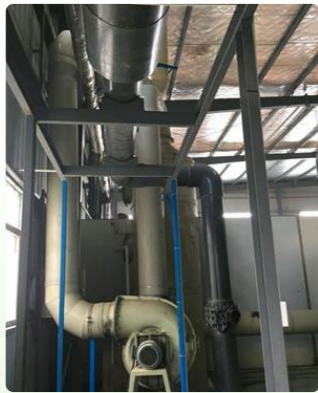
1号厂房制液系统硫酸雾净化塔
