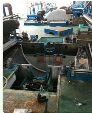
1号厂房制液系统硫酸收集装置
