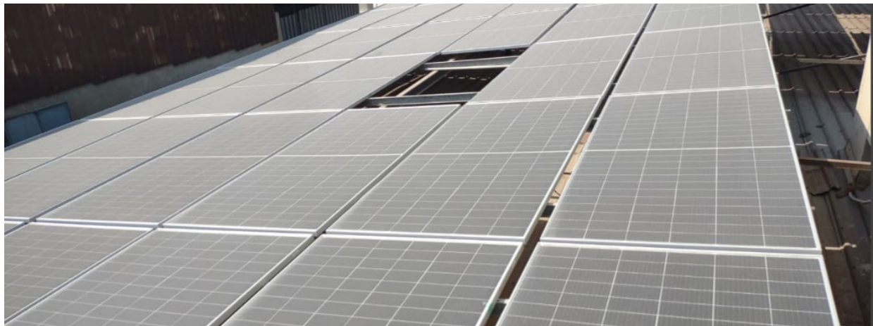
巴基斯坦合资工厂屋顶光伏现场图
