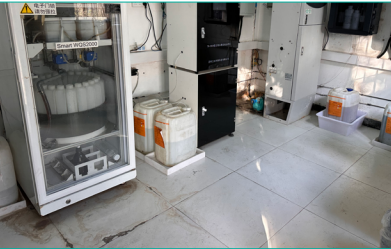
废水总排放口在线监测
