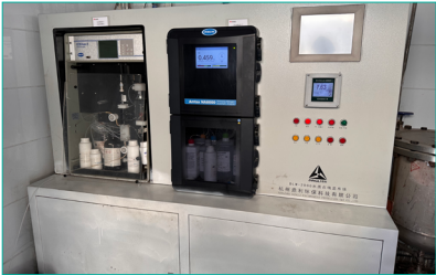
460 污水站在线监测
