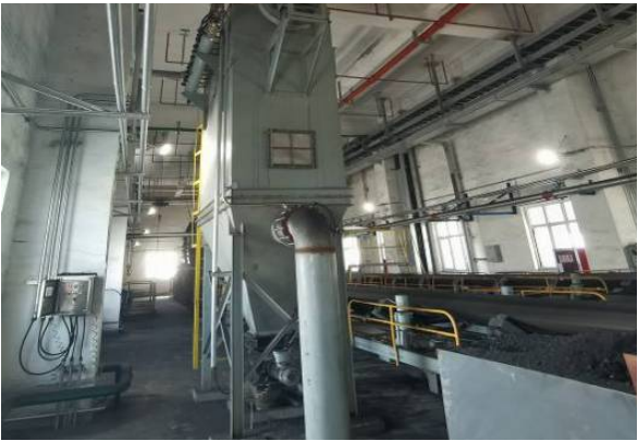
原煤仓顶除尘器
