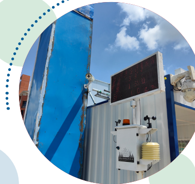
扬尘监测系统
