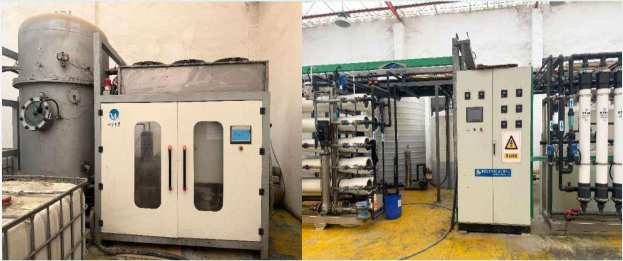
金刚线新建成含镍废水处理装置图
