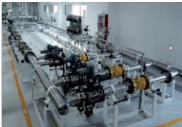
高压环道鉴定装置
