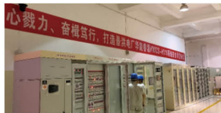
景洪电厂“华能晋源 HNCIS-H316”系统首台示范机组
