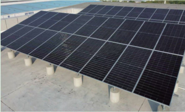
▲ 公司总部办公楼屋面光伏
