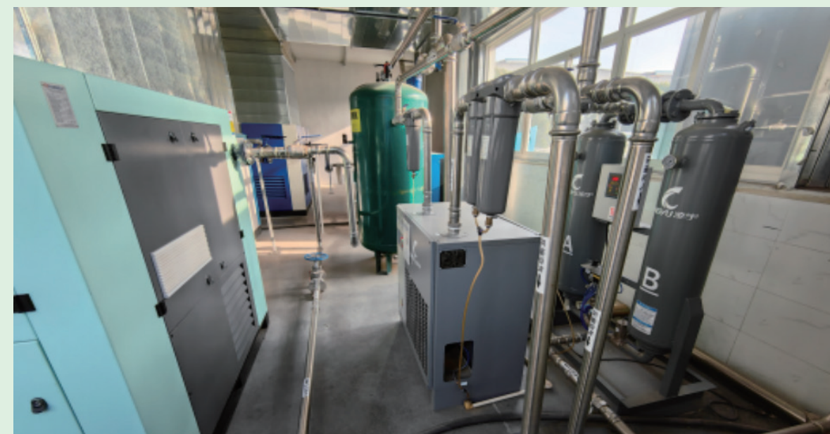
▲ 集中并联改造后的空压机系统
