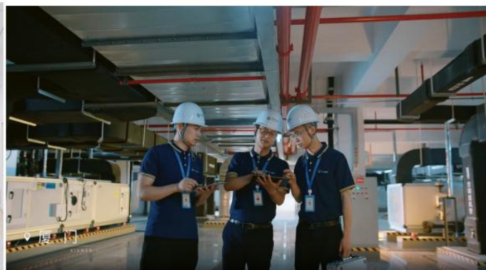
运维技术支持
