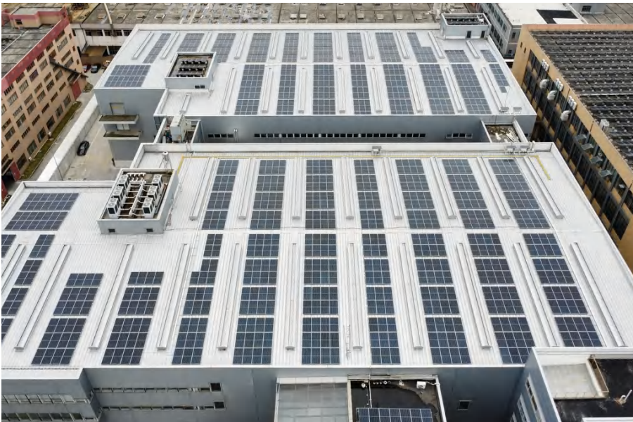
新厂650KW屋顶光伏项目
