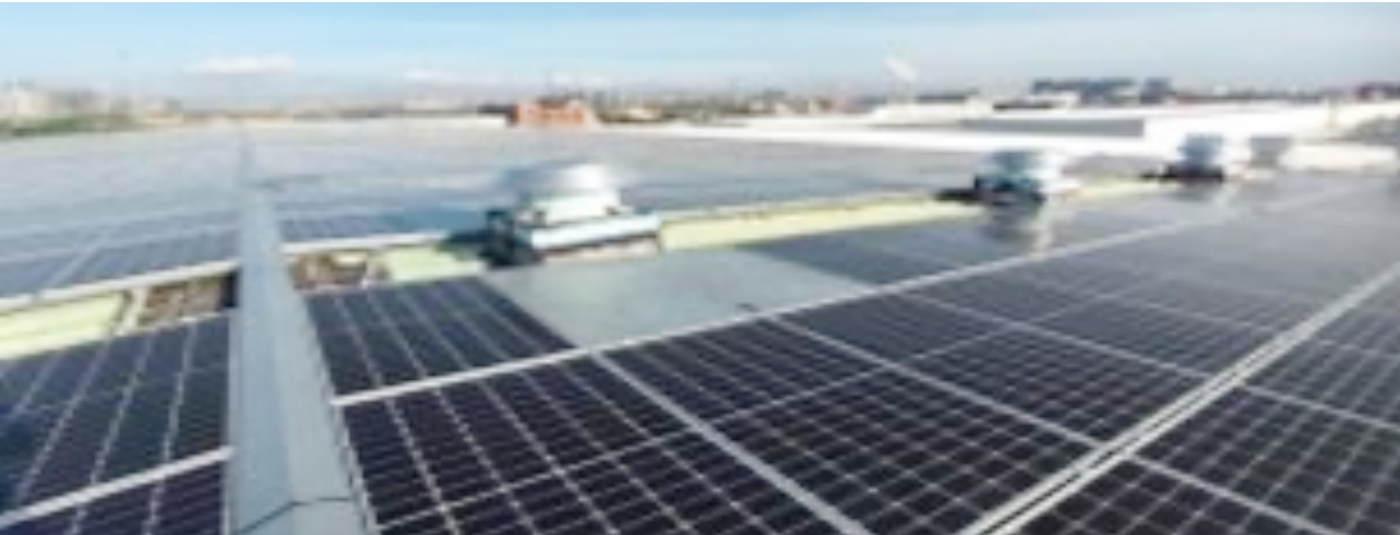
光伏发电项目
