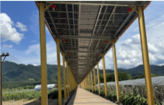
云南省勐腊县“新能源+乡村振兴”分布式廊道光伏项目
