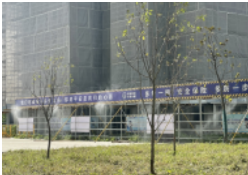
围墙喷淋设施减少扬尘
