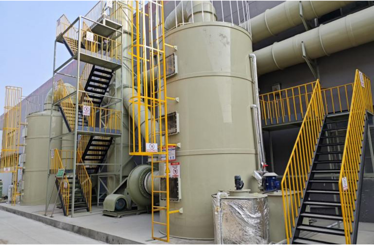
圣阳股份废气处理设备
