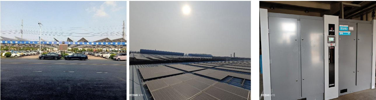
圣阳股份太阳能光伏发电项目
