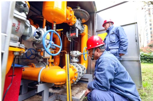
贵州燃气工作人员检查小区燃气调压设施运行情况
