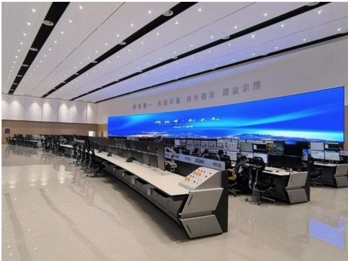
云南通威绿色能源项目调度大厅
