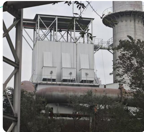
公司超低排放改造重点项目高炉热风炉废气脱硫，实现热风炉废气全脱硫，二氧化硫排放浓度低于 50\text{mg}/\text{m}^3 。
