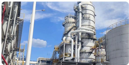
脱硫脱硝作业区立足极致能效，实现余热回收与利用，有效降低废气排放。
