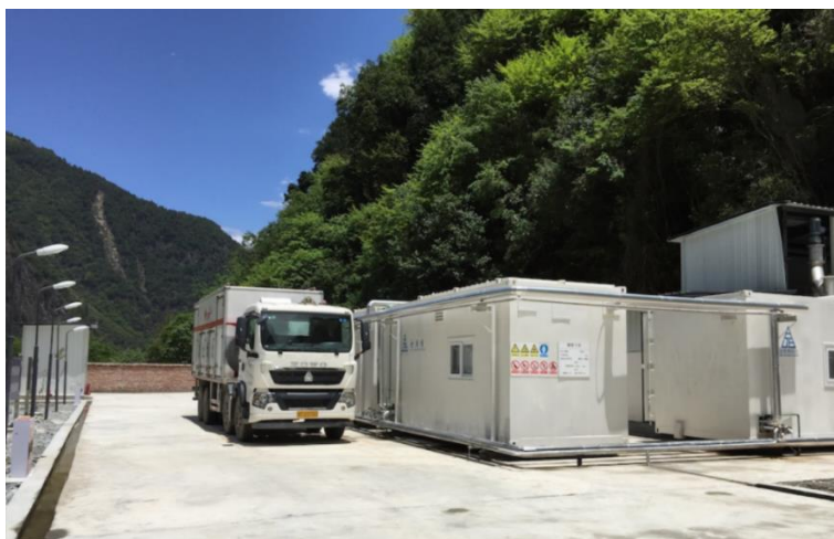
（JWL-S 型现场混装用乳胶基质工艺及设备系统）
