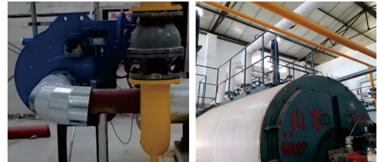
▲ 低氮燃烧锅炉
