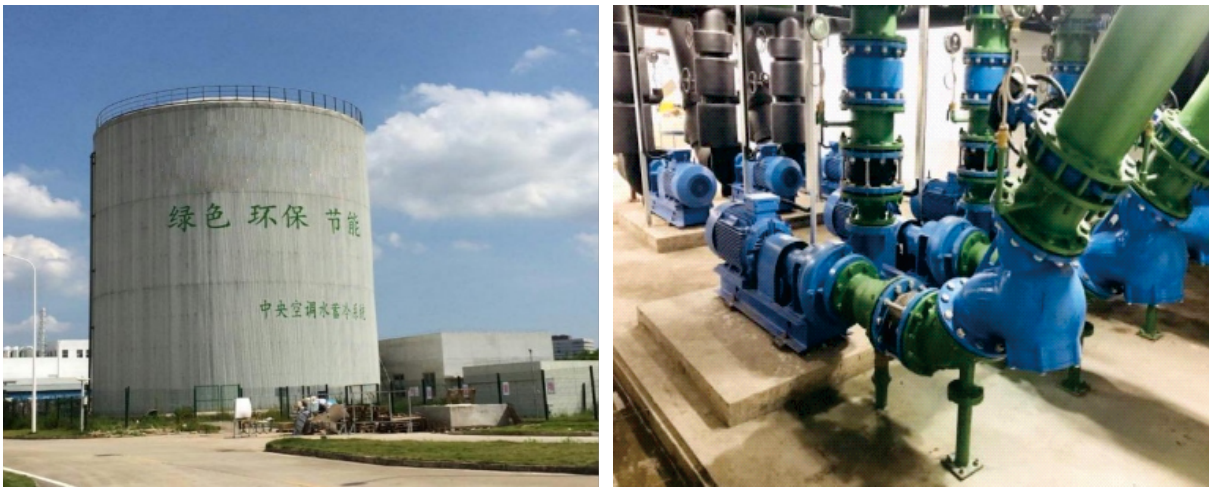
中央空调水蓄冷
