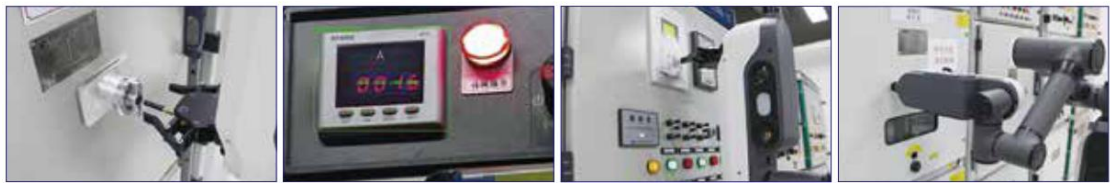
紧急分闸 智能巡检 继电保护操作 局放检测
