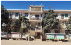
拆除前的危房
