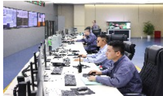
浙能电力运行人员认真监盘，精细操作
