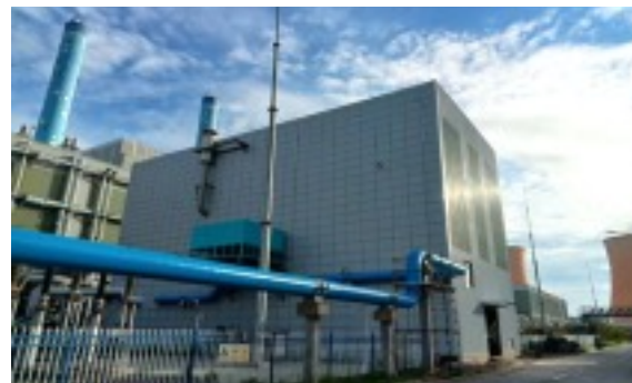
浙能滨海热电集中供压缩空气增容改造项目 5号空压机正式投运
