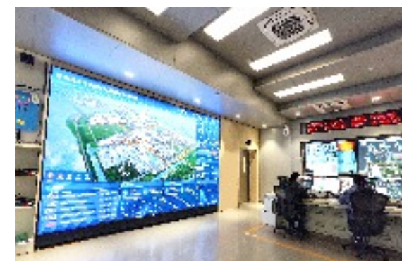
浙能滨海热电综合能源管理平台 投射于三期集控室大屏
