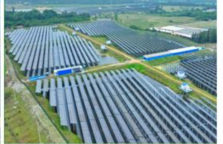
中广核文昌翁田 100MW 农渔光互补光伏发电项目
