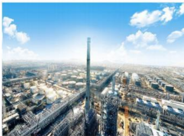
浙石化年产4000万吨炼化一体化项目
