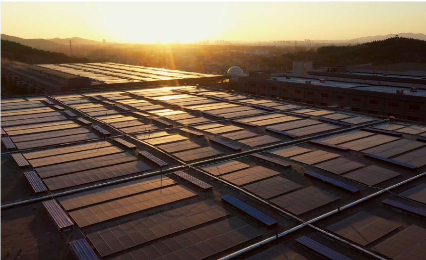
公司利用厂房屋面建设光伏系统
