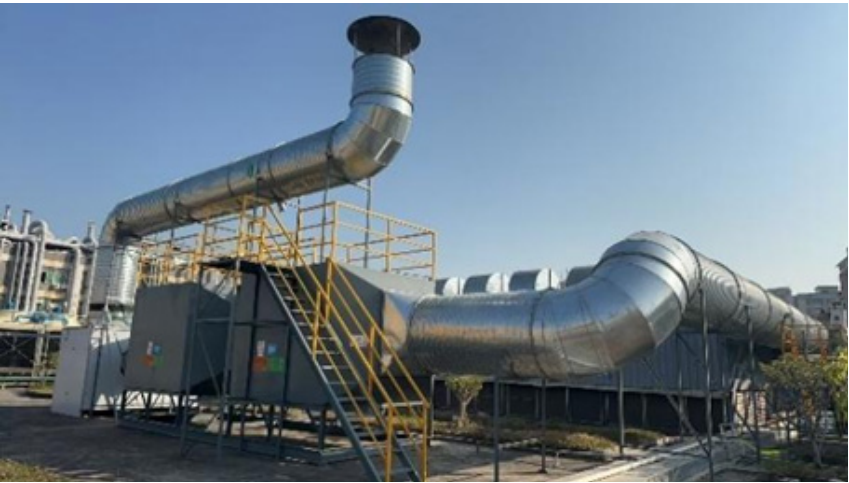
废气处理装置现场图片
