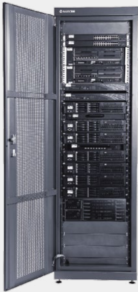
集群交换中心
