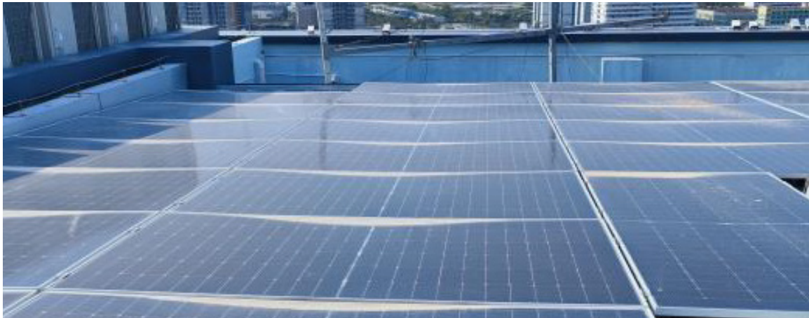
广东奥普特科技股份有限公司261.82kW分布式光伏发电项目（局部）
