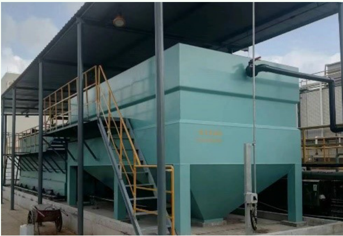
尼龙来水预处理沉淀池
