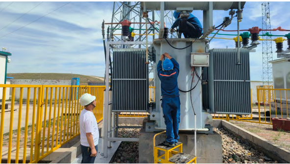
昊华精煤开展电力系统高温隐患排查
