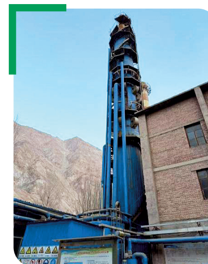
▲ 20 吨大锅炉脱硫脱硝一体装置
