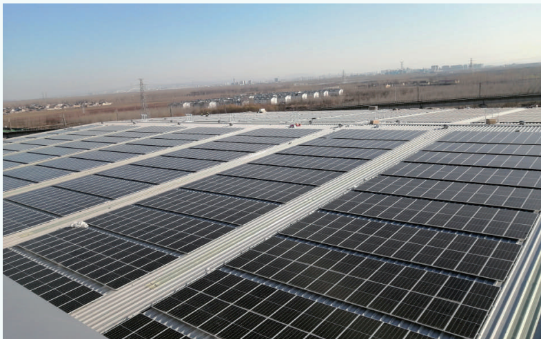
山东莱钢3.5MW光伏项目
