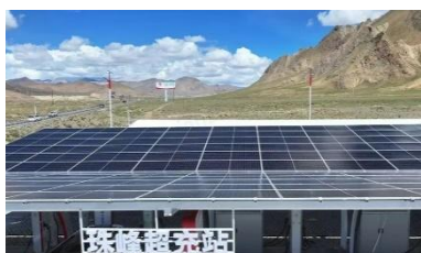
珠峰光储超充站
