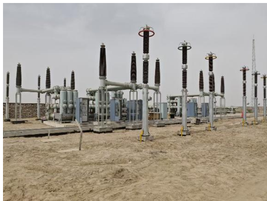
深能疏勒 2000MW 光储一体化项目
