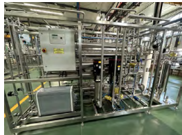
RO 废水回收装置
